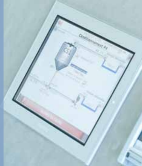
Bildschirm eines PLC Systems am Vorbereitungstank
