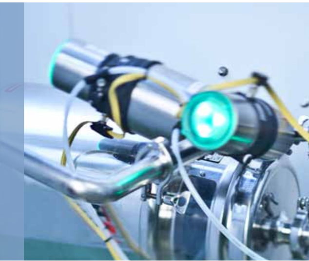
Automatisiertes Membranventil an der CIP Station
